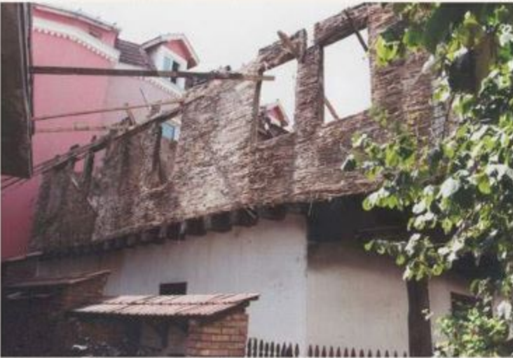
Гигина кућа након пожара 2008. године (извор: ЗЗСК Ниш, Ј. Шурдиловић, 2008)
